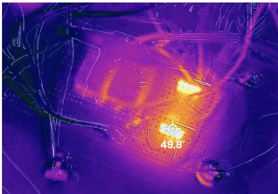
Abb. 13: Ein Kühlelement für die Spannungsregler erscheint sinnvoll
